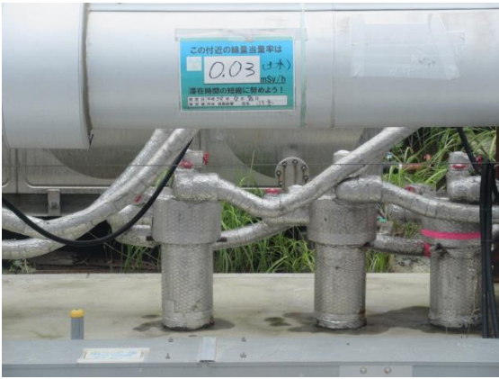
原発敷地内給水管に貼られた線量警告表示
